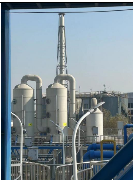
图 4.2-2 恶臭废气处理设施及排气管道
